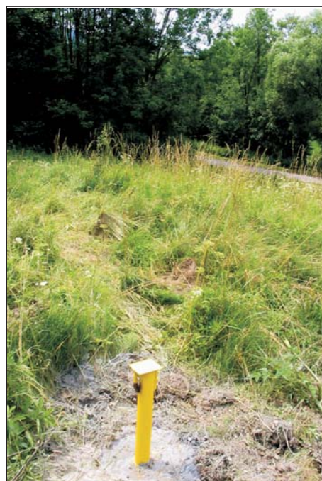
Fig. 20. Standpipe piezometer, Sękowa
