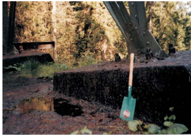
Ryc. 4. Zanieczyszczenie gruntu w otoczeniu drugiej podpory kolejki linowej na Kasprowy Wierch Fig. 4. Soils contamination around the second pillar of, the cable railway to Kasprowy Wierch
