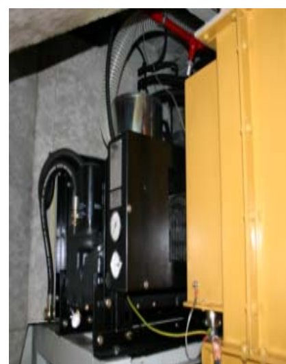
Rys.38. Widok na prostownik główny i sprężarkę powietrza
