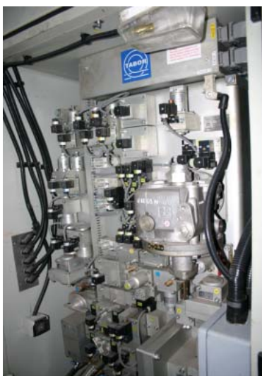
Rys.36. Widok na zabudowaną tablicę pneumatyczną
