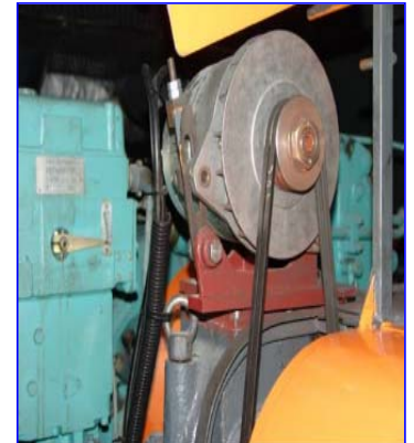
Rys.26. Widok na zabudowaną prądnicę pomocniczą (24V DC, 120A) do zasilania urządzeń pomocniczych
