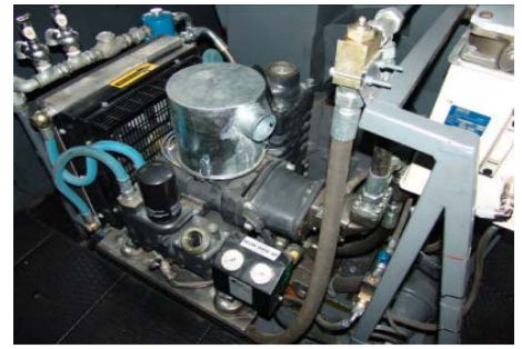
Rys.23. Widok na zabudowaną sprężarkę śrubową z napędem hydrostatycznym
