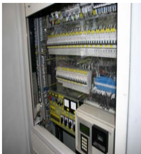
Rys.37. Widok na urządzenia i aparaty w szafie sterującej
