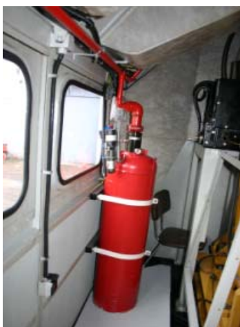
Rys.34. Zespoły stałej instalacji gaszącej
