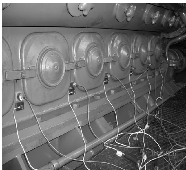
Rys. 8. Czujniki zamontowane w punktach pomiarowych 1, 2, 3, 4, 5 i 6
