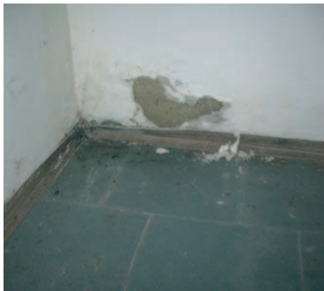
Fot. 2. Przykład odspojenia tynku, tuszczenia farby i wilgoci (fot. W. Eckert, 2010)
