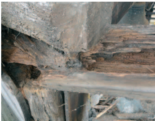
Fot. 1. Poziom „C” wieży; belka po lewej uszkodzona przez owady (widoczne otwory wylotowe), natomiast belka po prawej – przez grzyby domowe (pryzmatyczne spękanie drewna charakterystyczne dla rozkładu brunatnego)
