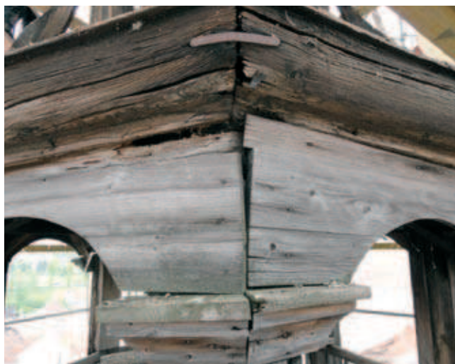
Fot. 3. Poziom „D” wieży; elementy drewniane zniszczone przez wilgoć i grzyby domowe
