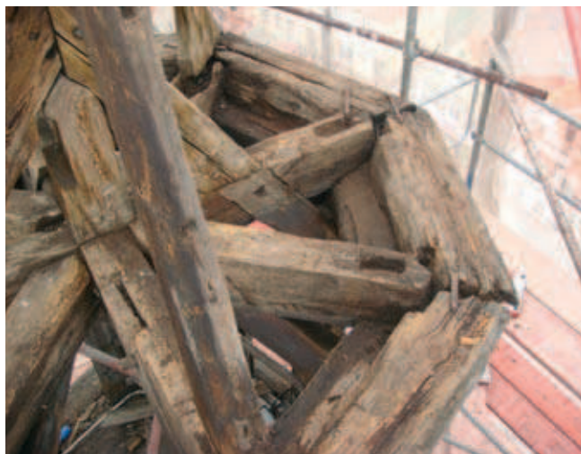
Fot. 4. Poziom „D”; widoczne zniszczenia elementów konstrukcyjnych przez grzyby domowe
