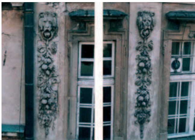
Rys. 3. Ornament gipsowy między oknami kondygnacji 3 piętra kamienicy pod Srebrnym Hełmem, stan przed remontem, fot. A. Konieczny
