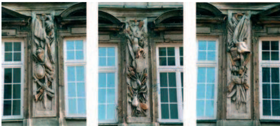
Rys. 4. Sztukateria wapienna (barokowa) między oknami 1 piętra kamienicy pod Srebrnym Hełmem, stan przed remontem, fot. A. Konieczny
