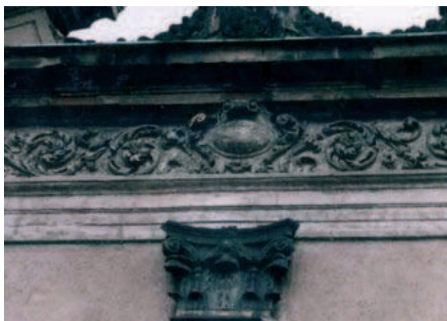
Rys. 6. Sztukateria w zwieńczeniu szczytu kamienicy pod Srebrnym Hełmem, stan przed remontem, fot. A. Konieczny
