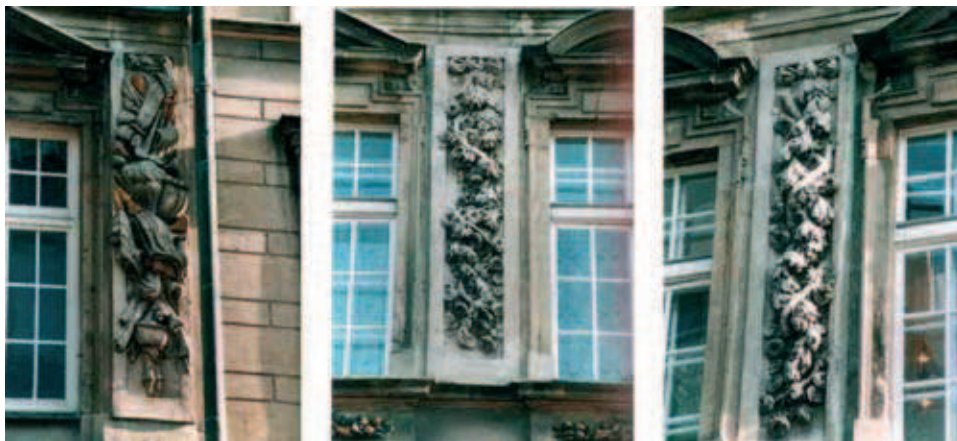
Rys. 5. Sztukateria wapienna (barokowa) między oknami 2 piętra kamienicy pod Srebrnym Hełmem, stan przed remontem, fot. A. Konieczny
