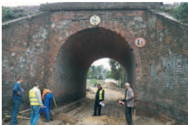
Rys. 4. Widok realizacji prac mających na celu obniżenie niwelety jezdni w obrębie przedmiotowego obiektu mostowego
