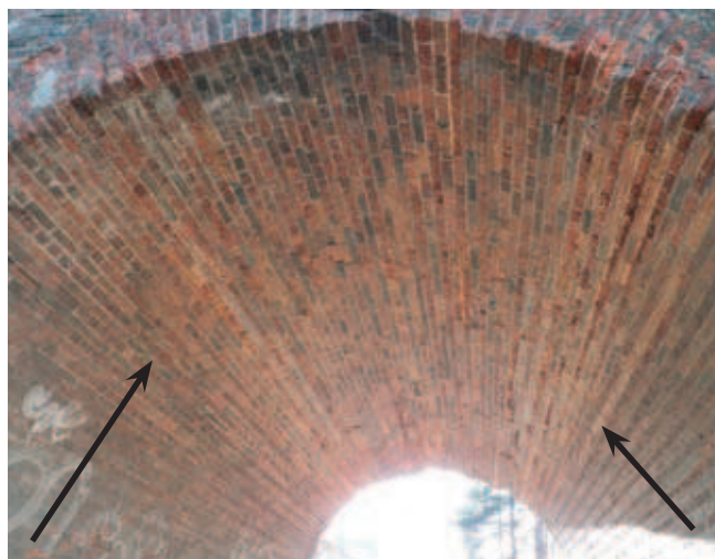
Rys. 2. Widok zarysowania sklepienia ceglanego przedmiotowego wiaduktu kolejowego
