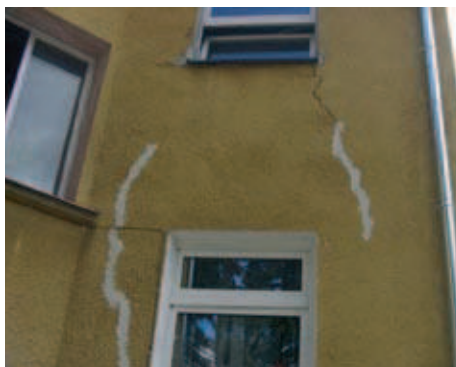
Rys. 8. Widok pęknięć pionowych w ścianie zewnętrznej budynku
