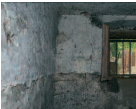
Rys. 10. Pęknięte ściany zewnętrzne piwnic
