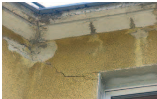
Rys. 6. Widok pękniętego gzymsu i górnej części ściany
