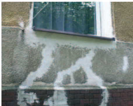
Rys. 9. Pęknięcia w ścianie pod oknem parteru
