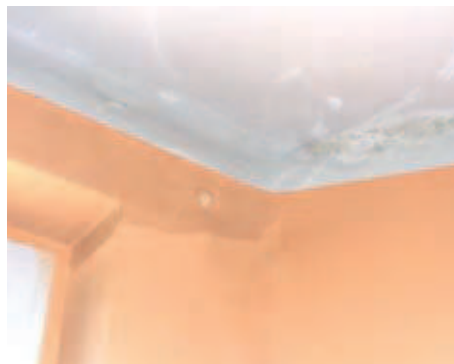
Rys. 12. Pęknięcia w ścianie zewnętrznej w mieszkaniu na I piętrze, przecieki na suficie
