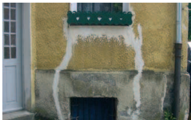
Rys. 7. Wejście do budynku, widok uszczelnionych pęknięć pod oknem
