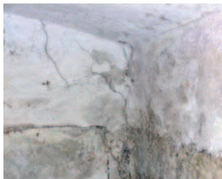
Rys. 11. Pęknięcia w ścianie wewnętrznej piwnic
