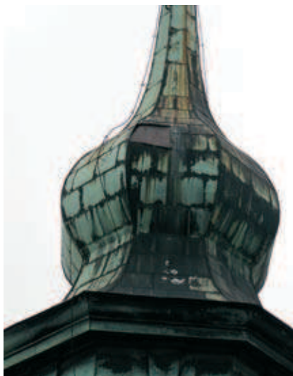
Rys. 4. Pokrycie wież przed wymianą oraz widok na uszkodzone elementy drewniane
