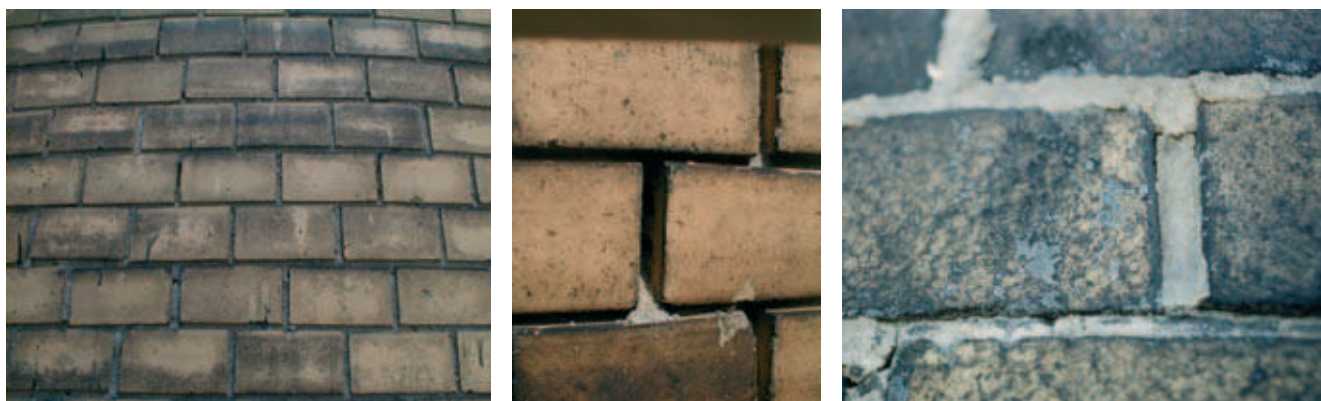
Rys. 2–4. Stan techniczny płaszczka komina od zewnątrz
