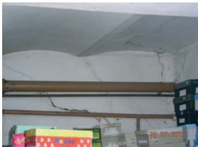
Fot. 5. Zarysowania ścian wewnętrznych w miejscach oparcia belek stropowych
