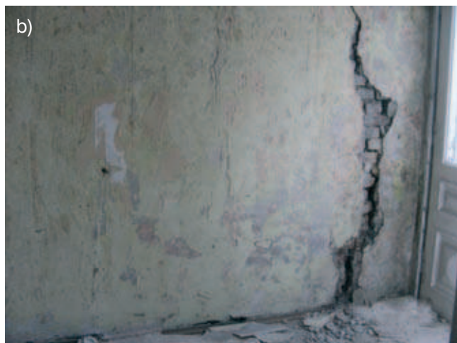
Fot. 4. a) Wskaźnik rozwarcia rys NeoStrain, b) zarysowania ścian wewnętrznych
