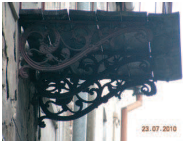
Fot. 6. Stan techniczny balkonów
