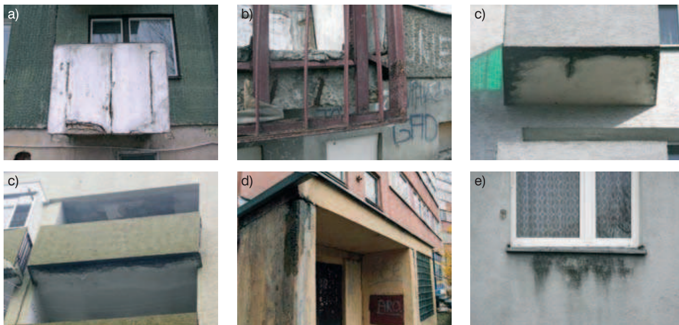
Rys. 6. Przykładowe uszkodzenia płyt osłonowych, balustrad i obróbek blacharskich: a) uszkodzenie osłonowej płyty balkonowej; widoczne zbrojenie, b) korozja i brak stabilności balustrady, c) zacieki i uszkodzenia tynku na podniebieniu balkonu, d) uszkodzenia obróbek blacharskich i muru przy wejściu do budynku; wyraźne odylatowania elementów prefabrykowanych, e) uszkodzenia parapetu okiennego; widoczne zacieki na elewacji
