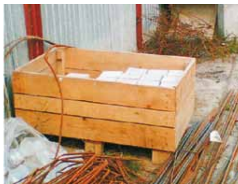
Rys. 8. Przykłady nieprawidłowego przechowywania próbek na budowie
