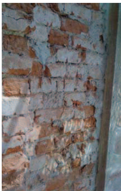
Rys. 5. Destrakcja muru ceglanego na skutek zastosowania szczelnego tynku cementowego
