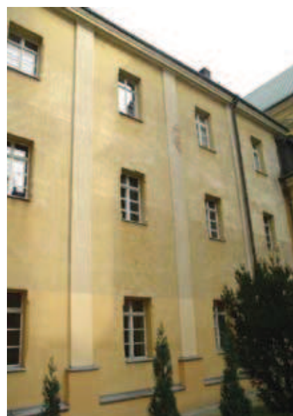
Rys. 3. Przykład podniesienia wysokości zawilgocenia muru na skutek wykonania szczelnej powłoki malarskiej
