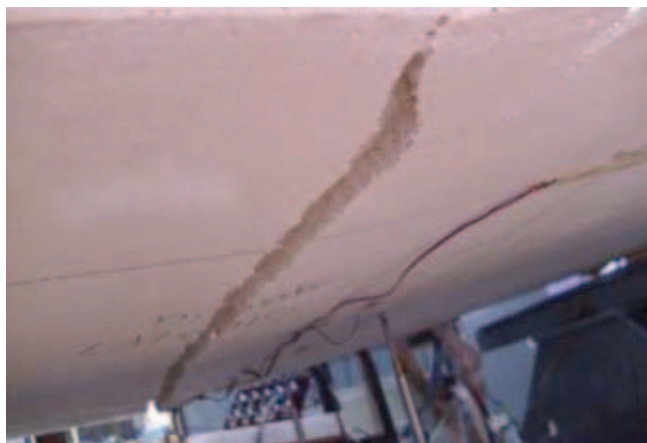
Rys. 2. Pęknięcie dolnej okładziny panelu swobodnie podpartego
