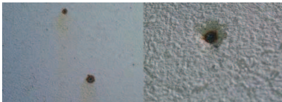
Rys. 1. Lewa strona: odpryski z widocznymi wyciekami przebarwiającymi fasadę. Prawa strona: głęboki odprysk z ciemnym jądrem na fasadzie
