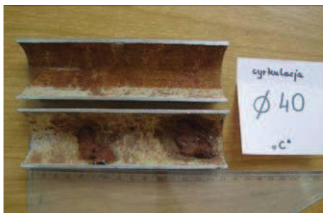
Rys. 4. Korozyja rur ocynkowanych transportujących ciepłą wodę w systemie ogrzewania
