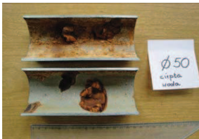
Rys. 3. Korozyja rur ocynkowanych transportujących ciepłą wodę użytkową
