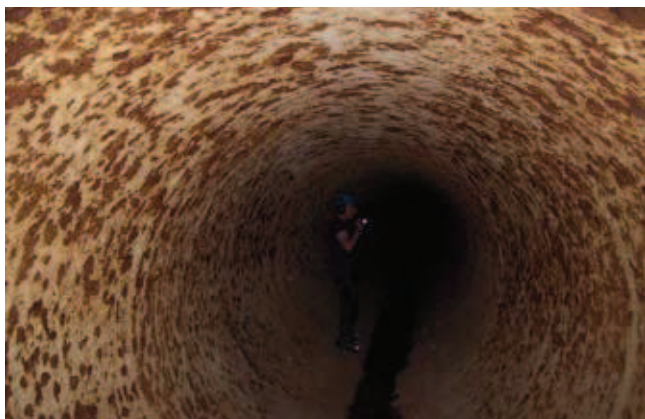
Rys. 2. Kolektor wody chłodzącej przed renowacją [8]
