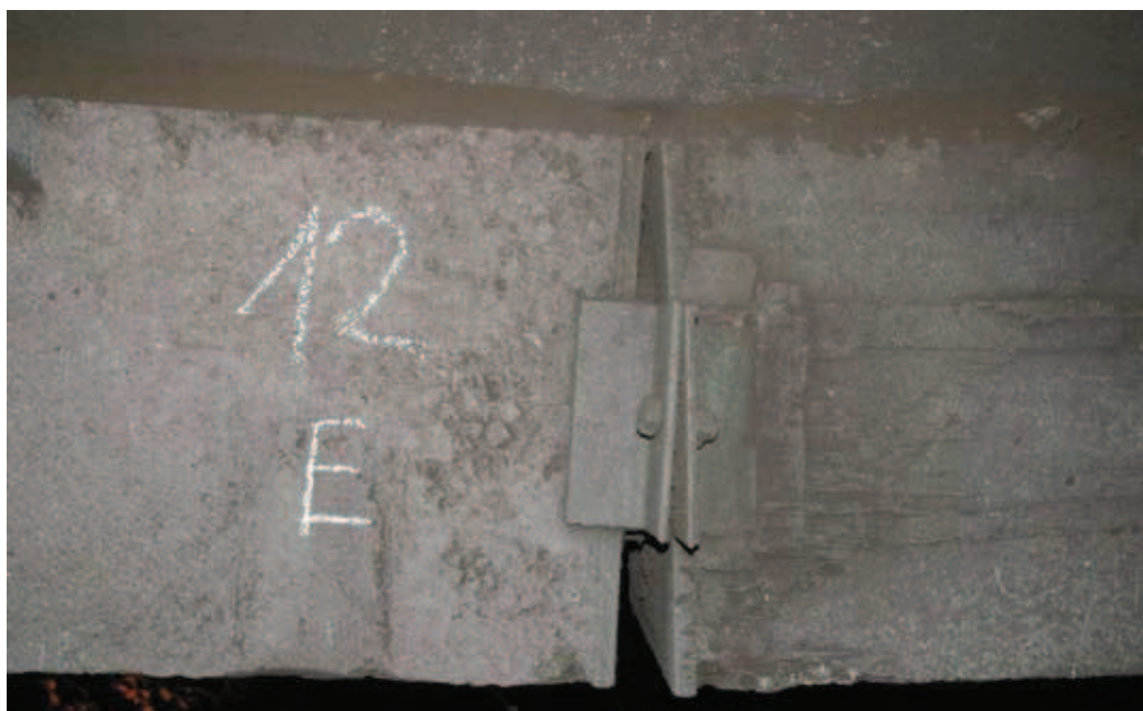
Rys. 4. Górny przegub ramy trójprzegubowej w osi 12 na poziomie +15,10 m – szerokość szczeliny u góry 14 mm, u dołu 54 mm [5]
