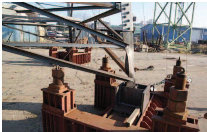
Rys. 3. Postać zniszczenia słupa M3w: zniszczenie krawężnika nogi ściskanej w strefie podporowej
