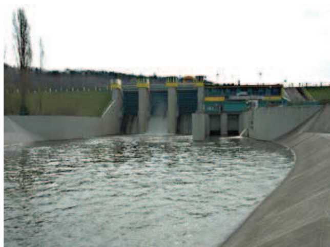
Rys. 3. Widok od strony wody dolnej na zaporę i blok upustowy przed katastrofą [4]
