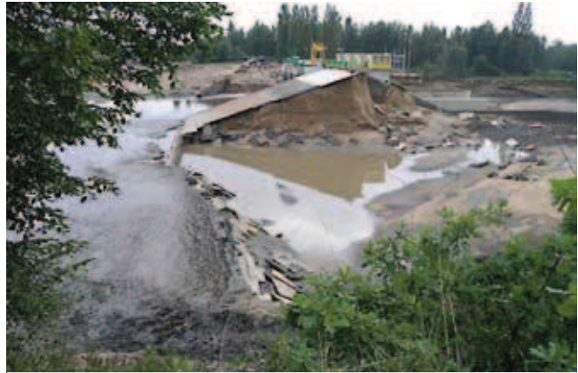
Rys. 3. Rozmycie prawej strony zapory
