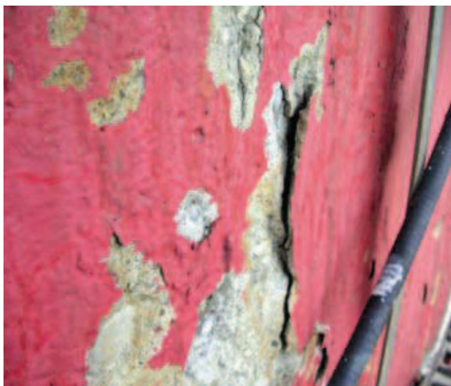
Rys. 4. Rdzawe zabarwienia wycieków i pęknięcia spowodowane pęcznieniem betonu
