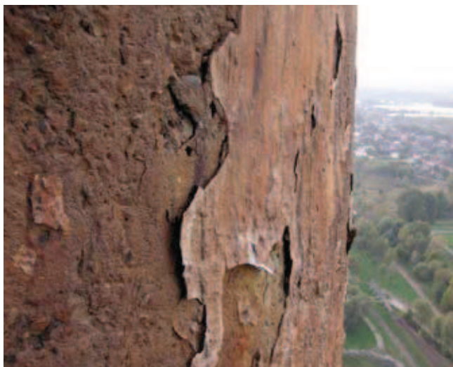
Rys. 2. Uszkodzenia mechaniczne spowodowane głównie korozją siarczanową
