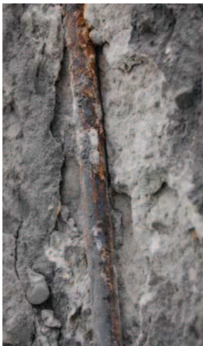
Rys. 2. Wyboczenie pionowego pręta zbrojenia trzonu komina
