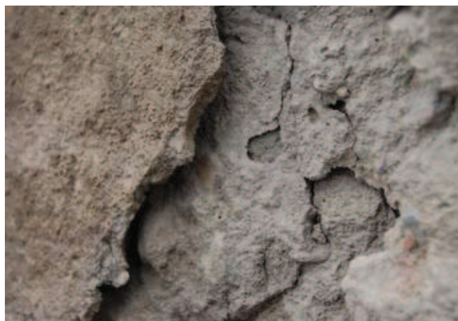
Rys. 1. Warstwowe odsłojenia betonu trzonu komina
