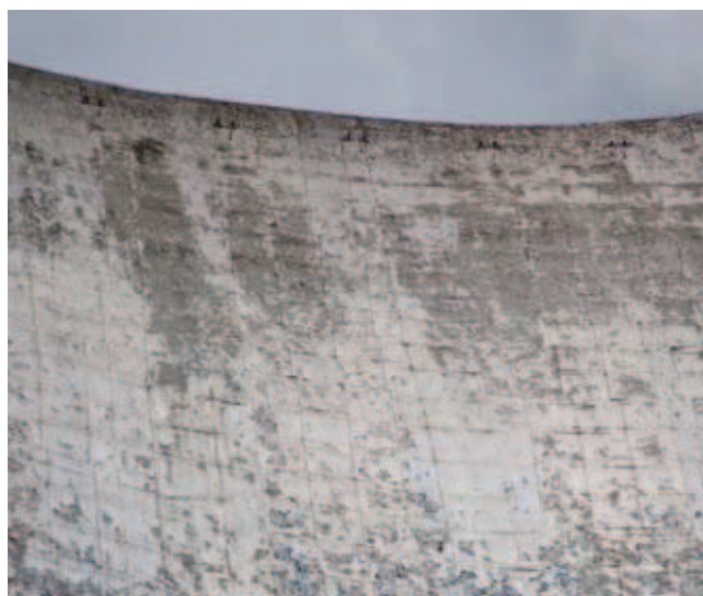
Fot. 4. Fragment powierzchni wewnętrznej ( B)
