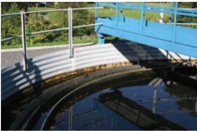
Rys. 4. Zbiornik osadnika wtórnego z widocznymi śladami rdzy do maksymalnego poziomu powierzchni ścieków
