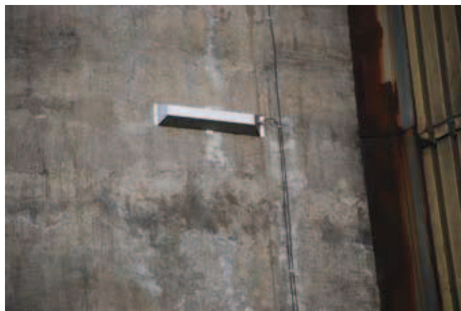
Rys. 7. Widok czujnika zamontowanego na zbiorniku, zabezpieczonego obudową mechaniczno-termiczną
