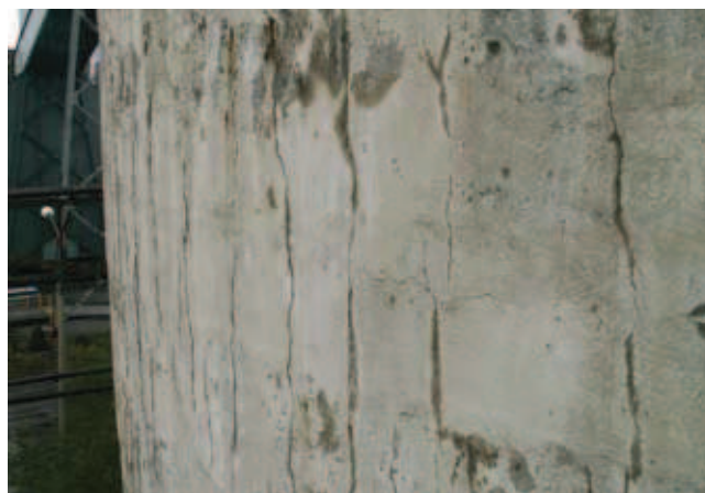
Rys. 4. Przykład pionowych rys na zewnętrznej powierzchni płaszcza
