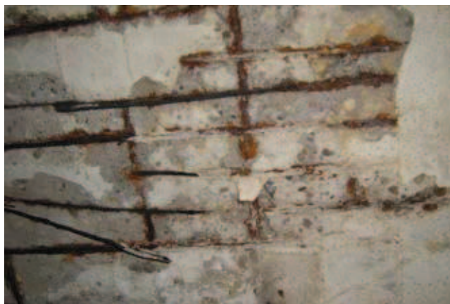
Rys. 2. Stopień zaawansowania procesu korozji elementów konstrukcyjnych – płyta stropowa
