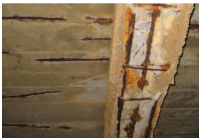
Rys. 3. Stopień zaawansowania procesu korozji elementów konstrukcyjnych – żebro
