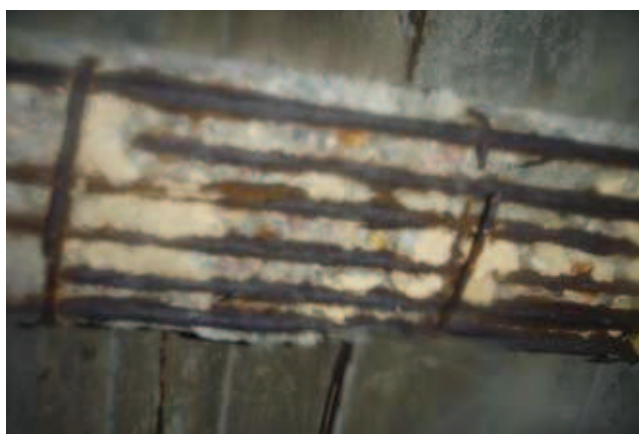
Rys. 4. Stopień zaawansowania procesu korozji elementów konstrukcyjnych – podciąg
