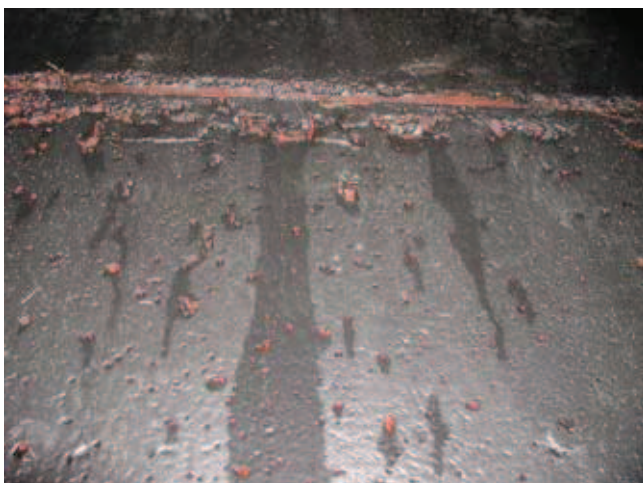
Rys. 6. Wycieki z miejsc nieciągłości powłok zabezpieczających po opróżnieniu zbiornika
