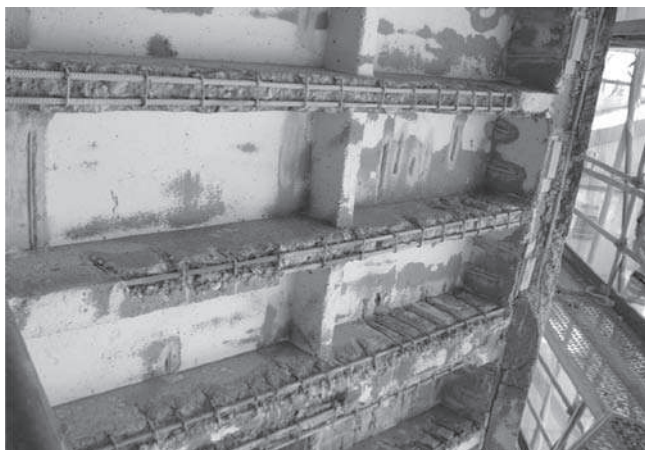
Rys. 7. Typowe nieprzewidziane projektem usterki elementu prefabrykowanego silosu na gips
