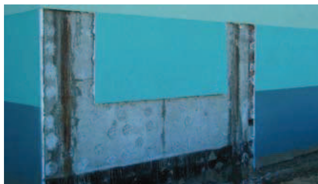
Fot. 6. Przecieki przy ramie stalowej, w której znajduje się demontowany element żelbetowy
