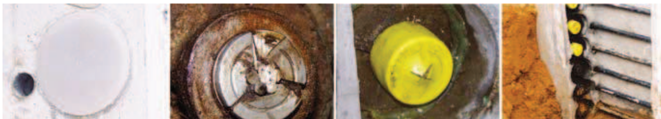
Rys. 4. Zabezpieczone zakotwienia cięgien sprężających, nieprawidłowe obcięcie cięgien sprężających – uszkodzenie zakotwienia, pęknięte zabezpieczenie antykorozyjne, zakotwienia poniżej powierzchni terenu po odkopaniu – widoczny brak zabezpieczenia zakotwień
