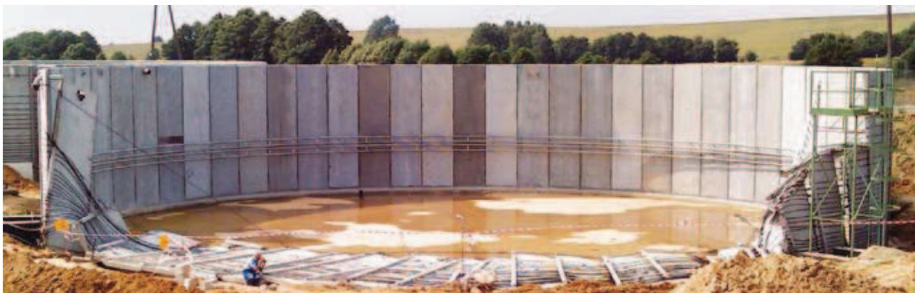
Rys. 2. Zbiornik nr 5 po katastrofie
