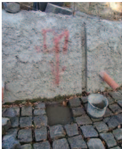
Rys. 3. Jakość wykonanych robót betoniarskich
