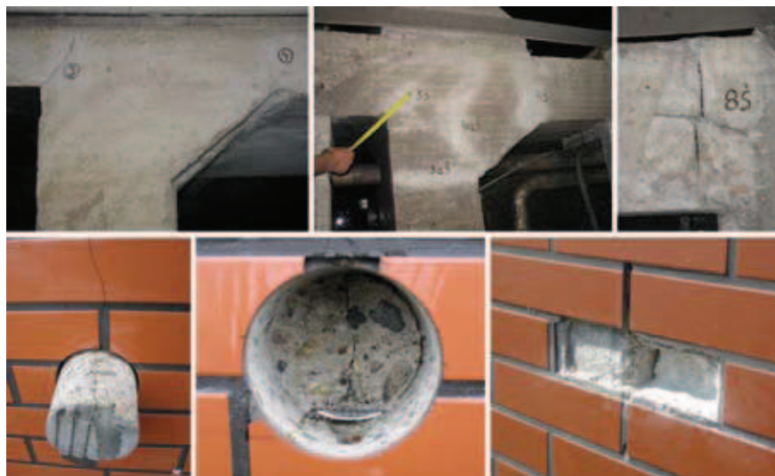
Rys. 2. Widok zarysowania ścian w osi B i C, odwierty w miejscach rys oraz uskok ściany w strefie przerwy roboczej
