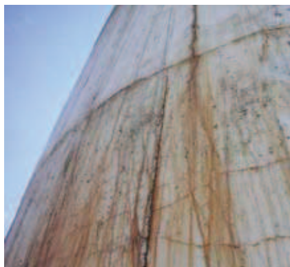
Rys. 3. Liczne rysy w ścianie komina
