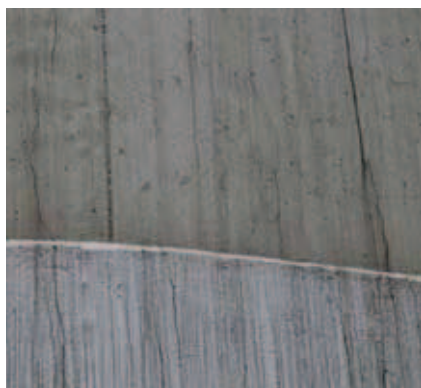
Rys. 4. Rysy w dolnej części ściany komina
