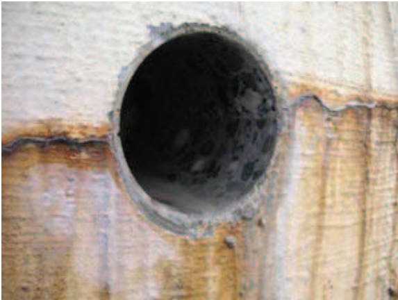
Rys. 6. Otwór w ścianie po odwiercie
