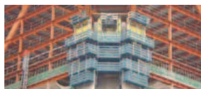
Rys. 12. Wznoszenie jednej z megakolumn przy zastosowaniu urządzeń formujących samowspinających i rusztowań Doka [20]
