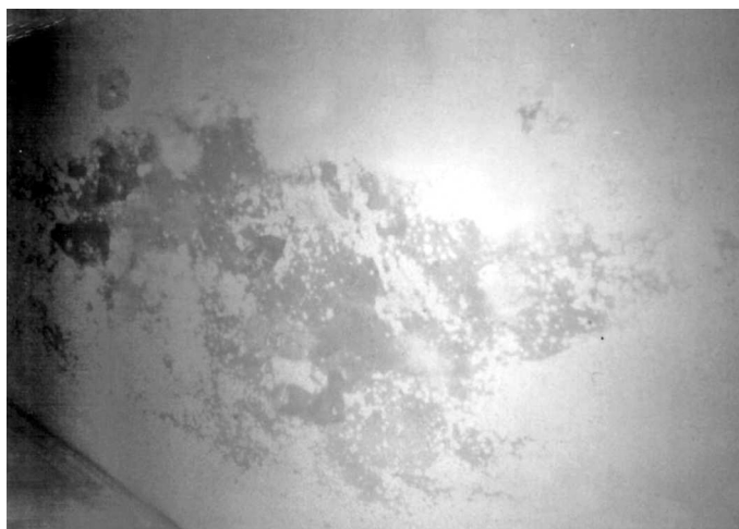
Ryc. 8. Widok rozległych plam na powierzchni tynku [9]
