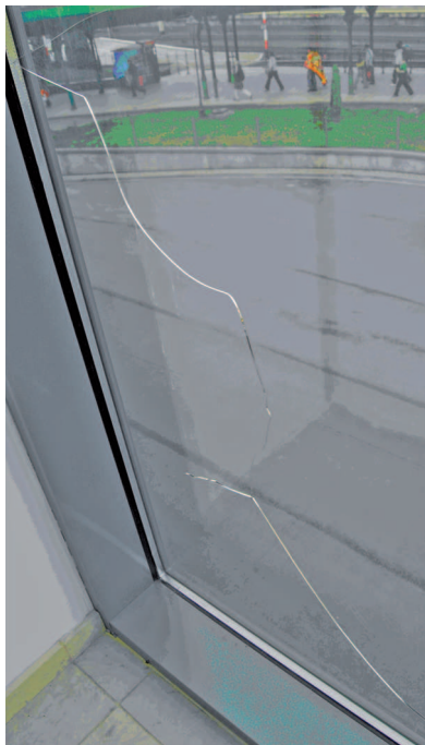
Ryc. 3. Pęknięcie w szybie zespolonej spowodowane pracą elementów konstrukcyjnych budynku
