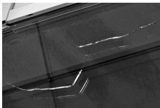
Ryc. 4. Pęknięcie w szybie zespolonej wynikłe ze zbytniego dopasowania szyby zespolonej do elementów konstrukcji
