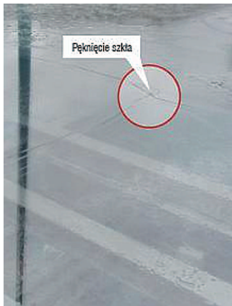
Ryc. 9. Pęknięcie w szybie zespolonej spowodowane naprężeniami termicznymi
