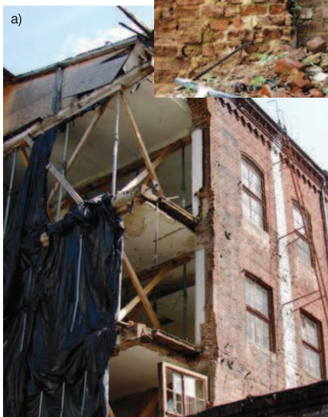
Rys. 23. Katastrofa zabytkowego budynku tzw. „Centrali” K. Scheiblera przy Pl. Zwycięstwa (dawniej Rynek Wodny) w Łodzi: a) fragment budynku od strony południowej po katastrofie, b) przełom muru
