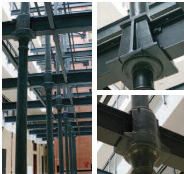
Rys. 18. Fragmenty szkieletu stalowo-żeliwnego w jednym z budynków kompleksu mieszkalnego „U Scheiblera” w Łodzi na Księżym Młynie
