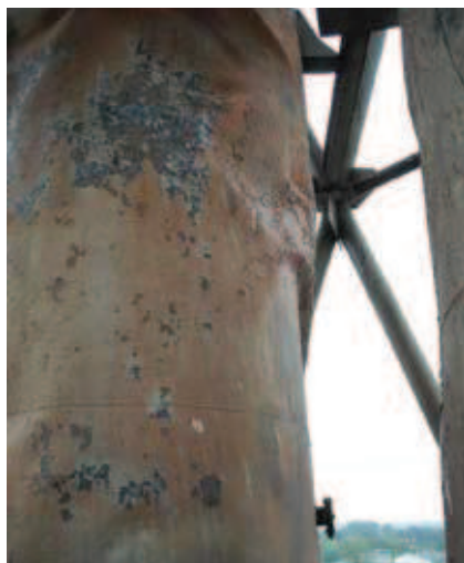
Rys. 5. Odkształcenia blach komina
