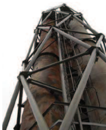
Rys. 6. Odkształcenia blach komina
