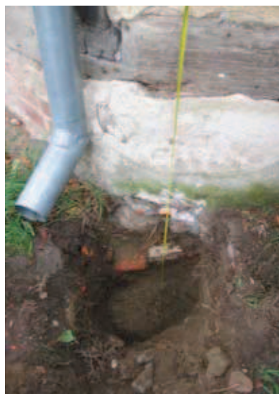
Rys. 2. Elewacja północno-zachodnia – fragment. Odkrywka fundamentu. Brak odsadzki fundamentu. Rura spustowa odprowadzająca wodę z dachu w bezpośrednim sąsiedztwie cokołu
