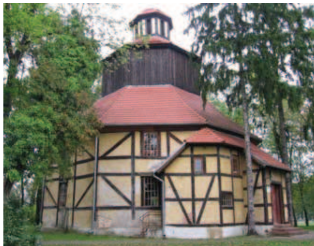
Rys. 1. Sękowice. Kościół. Elewacja południowo-zachodnia. Uszkodzony i zawilgocony cokół, skorodowana konstrukcja drewniana, znaczne ubytki tynku w murowanej ścianie wypełniającej konstrukcję słupowo-ryglową
