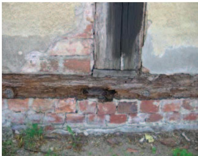
Rys. 3. Elewacja północna – fragment. Skorodowana belka podwalinowa, rozluźnione wiązanie cegieł cokołu, ubytki tynków. Pomiędzy słupem a skorodowaną i skompresowaną belką podwalinową, szczelina uzupełniona wkładką z desek
