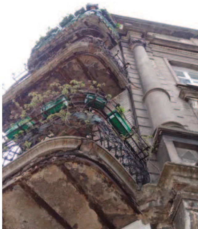
Fot. 4. Niepowtarzalne piękno balkonów budynków secesyjnych może bezpowrotnie ulec zniszczeniu
