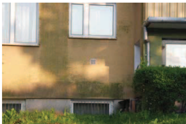
Rys. 14. Zawilgocenie widoczne na elewacji po ociepleniu budynku przy ulicy Skautów. Fotografia A. Ostańska
