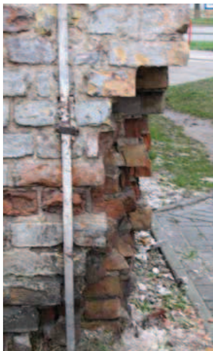
Rys. 4. Widok zniszczonego naroża budynku
