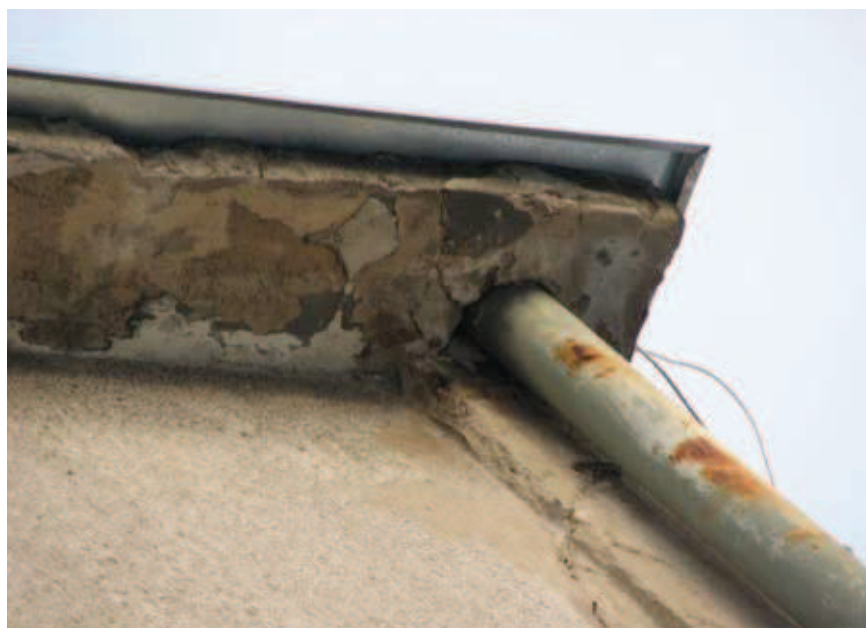
Rys. 6. Skutki jednoczesnego oddziaływania czynników degradacji: obecności wody i cyklicznych zmian temperatury
