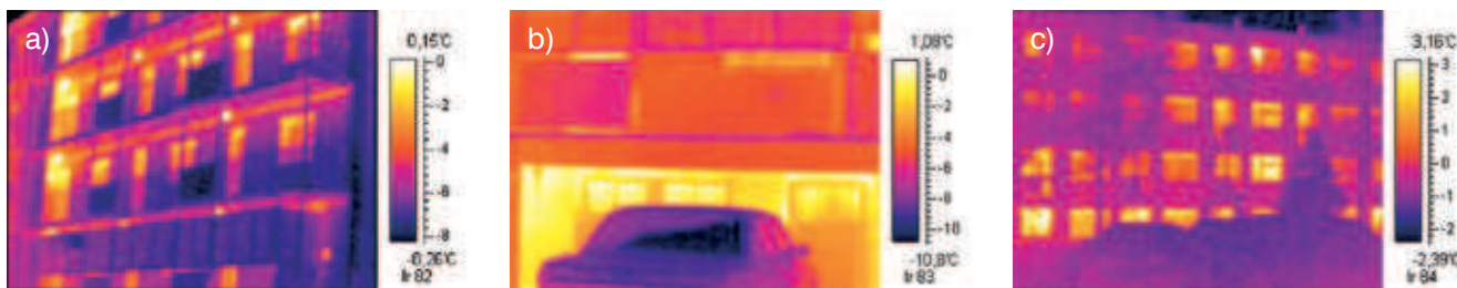
Rys. 5. Termogramy elewacji: północnej – a) mostki liniowe na styku z płytą galerii, b) nieocieplane cokoły i zła jakość stolarki drzwiowej; i południowej – c) zróżnicowana jakość termiczna stolarki okiennej, szczególnie w loggiach cofniętych, stan na rok 2011
