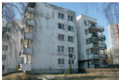
Rys. 6. Noskowskiego 8. Budynek prefabrykowany z 1980 roku po ociepleniu w latach 90. i częściowej wymianie stolarki okiennej
