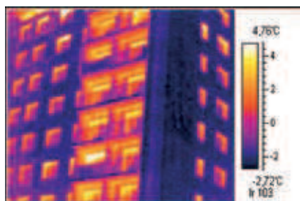
Rys. 16. Termogram do rysunku 14. Narożnik północno-wschodni. Mostki przy płytach loggii dostawianych
