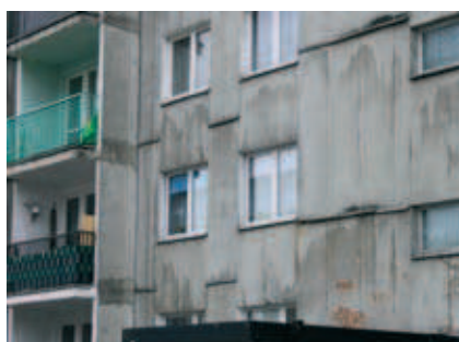
Rys. 17. Fragment budynku prefabrykowanego po I etapie ocieplenia. Zły stan płyt okładzinowych
