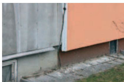
Rys. 18. Fragment budynku prefabrykowanego na styku I i II etapu ocieplenia. Zły stan płyt okładzinowych i stolarki okiennej, brak ocieplenia cokołu w obu etapach ocieplenia
