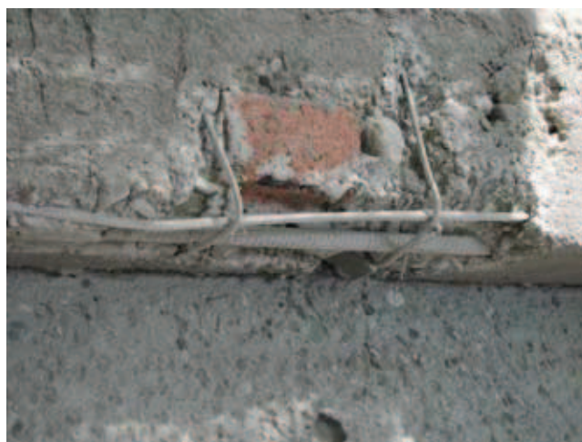
Rys. 4. Żebra żelbetowe pod przekryciem silosu z ubytkami w otulinie i kawałkiem cegły
