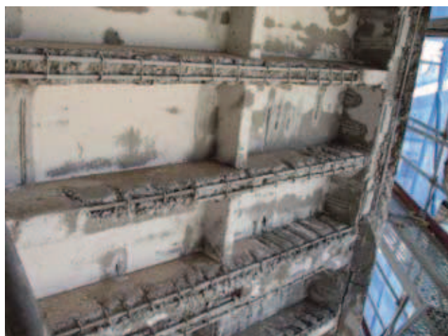
Rys. 3. Płyty prefabrykowane ściany silosu po usunięciu odspojonej otuliny i luźnych fragmentów betonu
