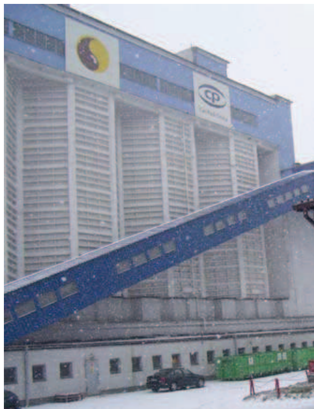
Rys. 1. Bateria silosów prefabrykowanych przed remontem
