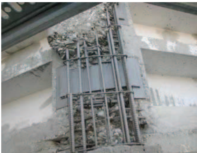
Rys. 5. Połączenie płyt prefabrykowanych w obrębie pilastrza, widoczne są duże ubytki betonu w pilastrze (odkryta pozioma blacha) i rozfrakcjonowanie kruszywa w betonie
