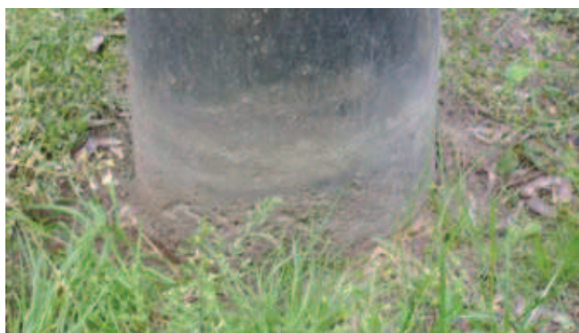
Rys. 7. Powierzchniowe uszkodzenie betonu słupa na styku z gruntem spowodowane oddziaływaniem agresywnego środowiska organicznego
