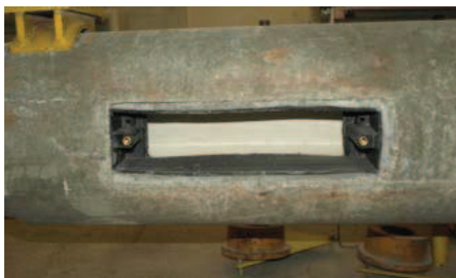
Rys. 3. Nieuzbrojona wnęka bezpiecznikowo-złączeniowa
