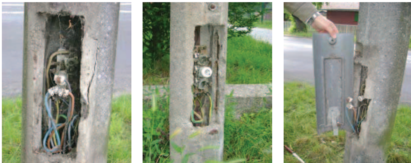
Rys. 2. Przykłady uszkodzeń krawędzi oraz odstąpięte zbrojenie w obszarze wnęki bezpiecznikowo-złączeniowej
