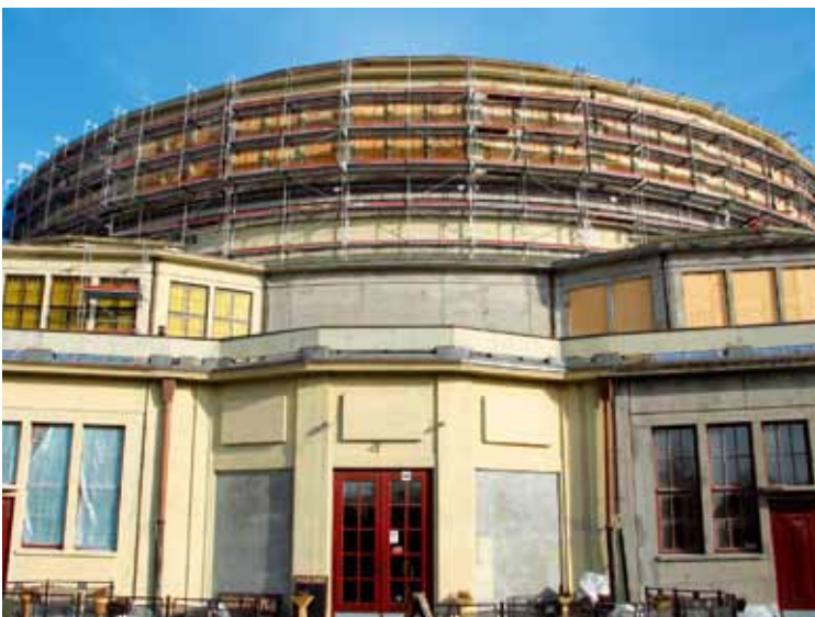
Fot. 6. Widok fragmentu ściany Hali Stulecia we Wrocławiu w czasie prac naprawczych, fot. L. Kona-rzewski
